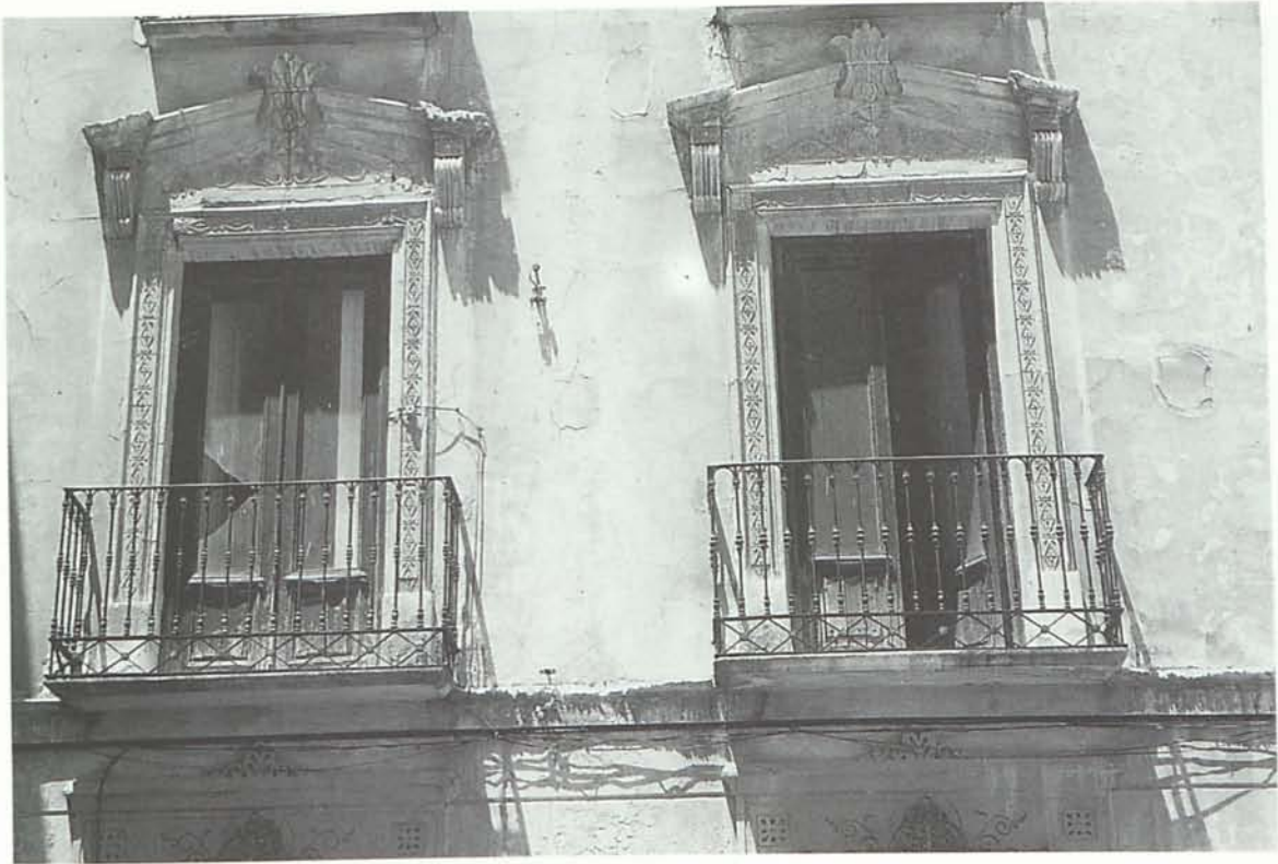
Balcones de una casa decimonónica burguesa, situada lindando con el Ayuntamiento en la plaza principal. Pese a la opinión de Ramón de Cala, lo más destacable de Sorbas son estos edificios que le otorgan señorío como ocurre con la Casa del Duque de Alba, la de los Piqueras, el Teatro Villaespesa (restaurado) o la Iglesia.
