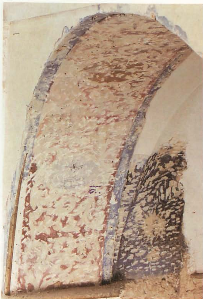
Arco 6. Ejemplo de diversas alteraciones tanto en soporte como en la capa pictórica
