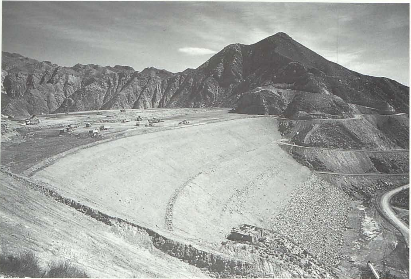
Proceso de levantamiento del dique de la presa mediante tongadas. Distingase la concentración de maquinaria pesada durante estos trabajos. (Fondo fotográfico de la Presa de Cuevas del Almanzora / Cuenca Mediterránea Andaluza / Agencia Andaluza del Agua)
