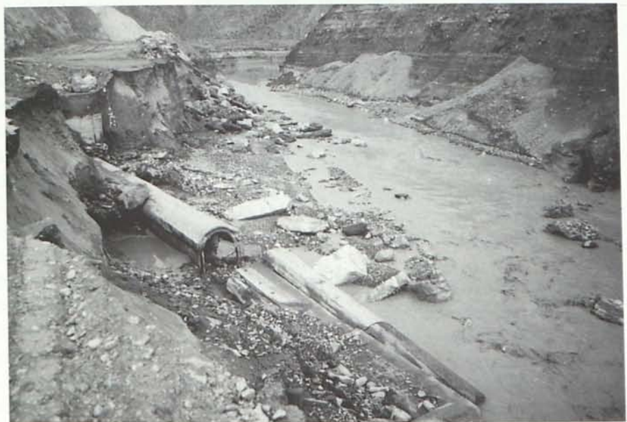
La riada de noviembre de 1982 causó notables destrozos en las obras de la presa que se habían iniciado unos meses antes. Este evento climatológico obligó a replantearse el proyecto inicial, el cual sufriría algunas modificaciones. Las imágenes están tomadas el 3 de noviembre de 1982. (Fondo fotográfico de la Presa de Cuevas del Almanzora / Cuenca Mediterránea Andaluza / Agencia Andaluza del Agua)
