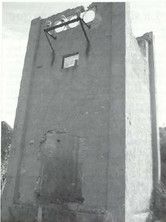
Torre del transformador en el Hoyo Júpiter.
