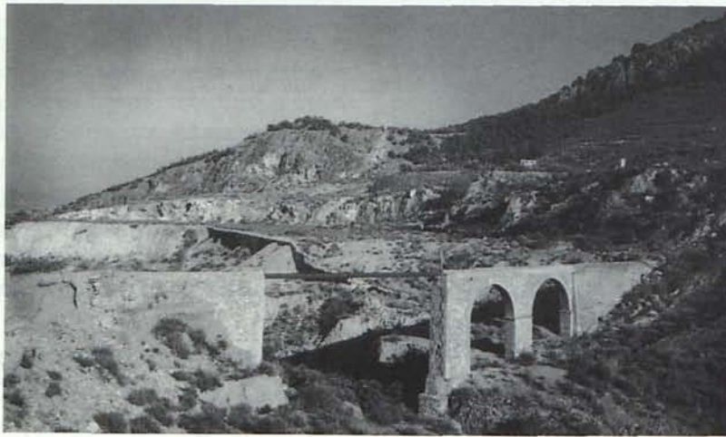
Acueducto de la Rambla de Huéchar y Paraje del Moralillo al fondo, un recurso paisajístico y etnográfico cercano a proteger
