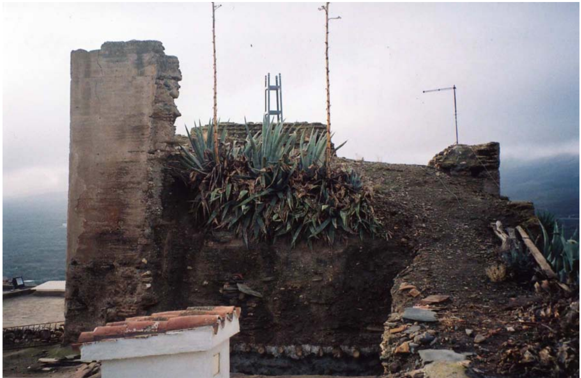
Lám. I Cara norte de la torre una vez eliminada la vivienda adosada.
