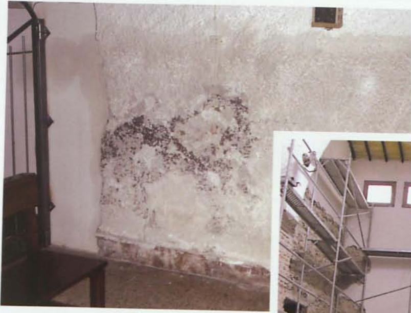
Estado de los muros de la parroquia antes de comenzar las obras.
