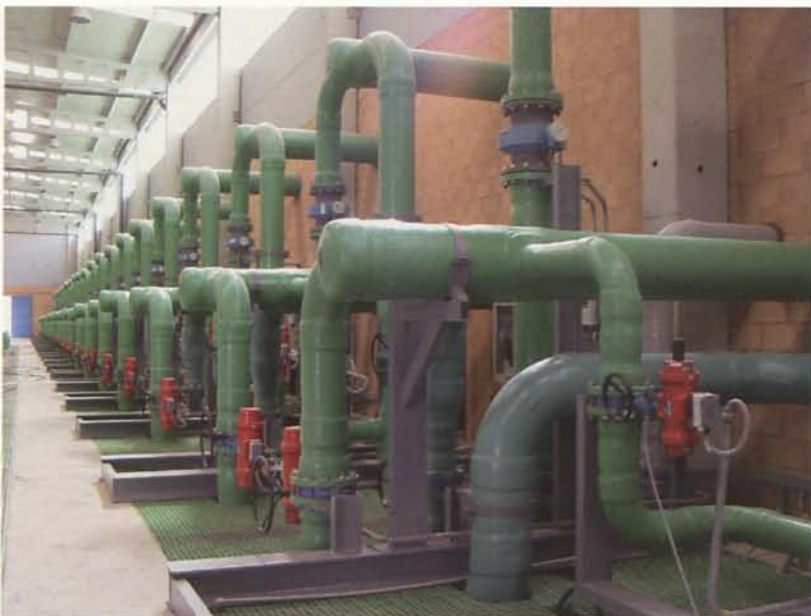
5. Colectores de filtros de arena. (Col. del autor)
