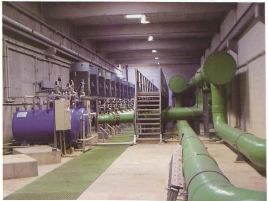
3. Sala de bombas de agua de mar. (Col. del autor)
