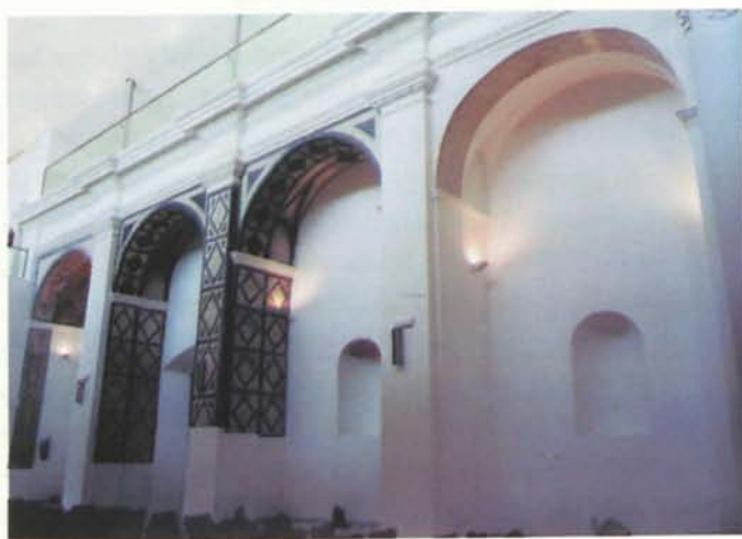
Fig. 43: Capillas restauradas del lado del Evangelio en la iglesia de los Mínimos de Vera, año 2004, tras la destrucción de la mayor parte de sus pinturas
