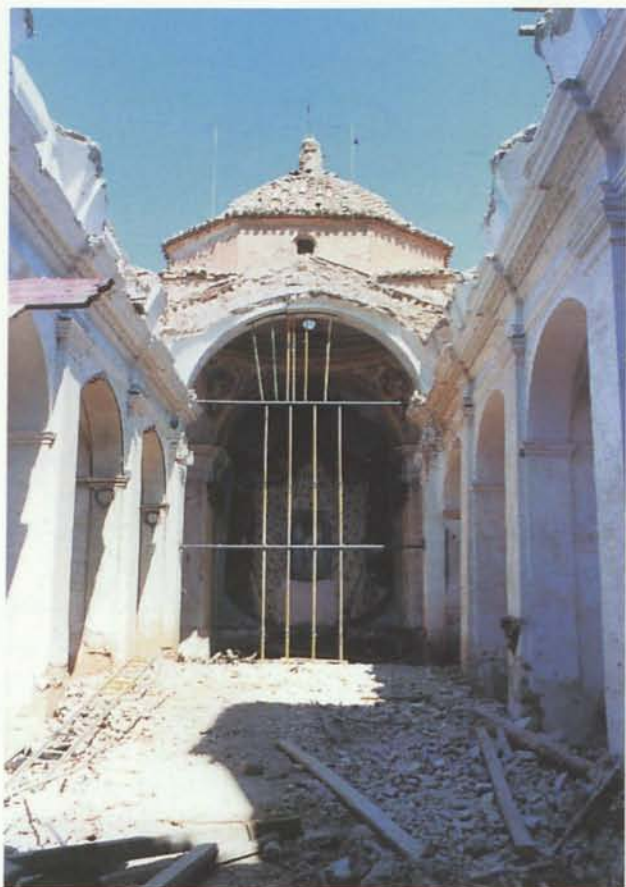
Fig. 8: Nave de la iglesia de los Mínimos hacia la capilla mayor el año 2000, tras la demolición de su bóveda.
