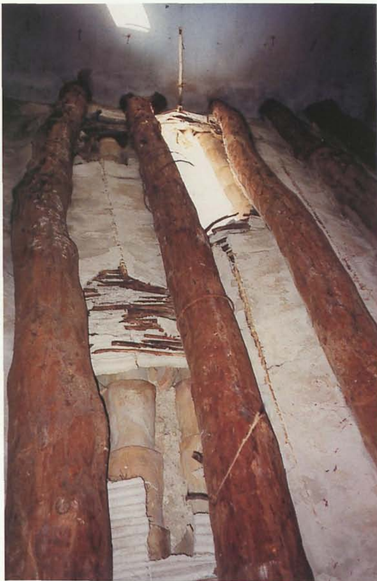
Detalle del estado de la techumbre de la Casa de la Tercia cuando se lleva a cabo la intervención. (Foto de Ramón García Ortega)
