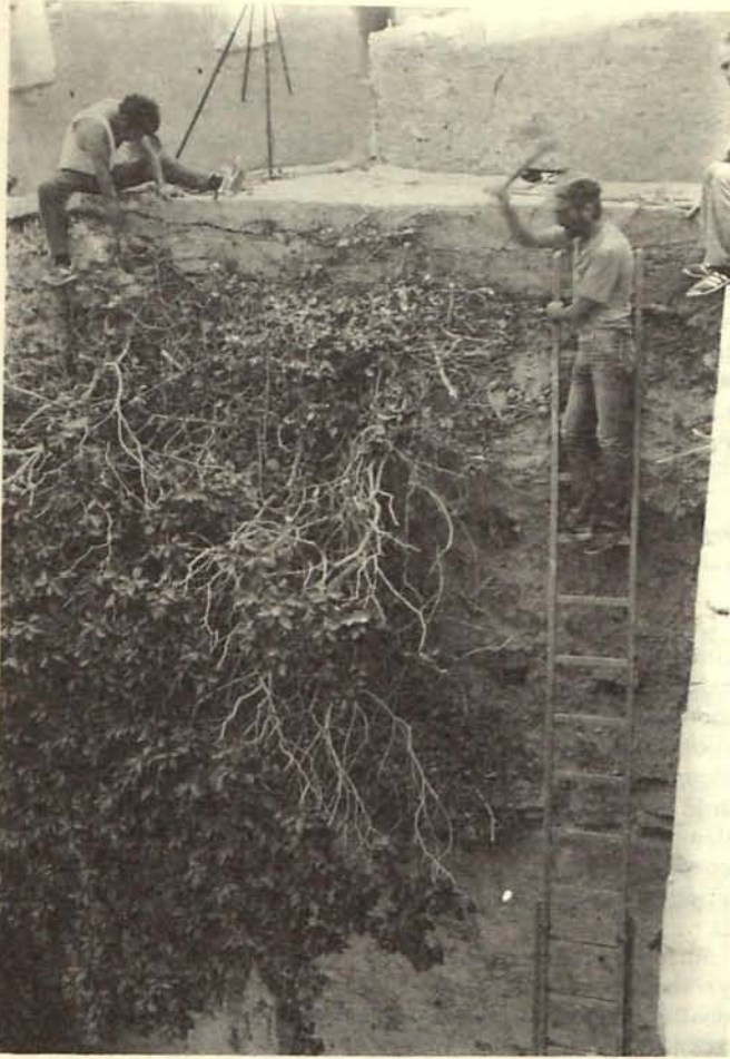
LAM. 2. La vegetación alcanzaba a veces un desarrollo excesivo: en la foto corte de la yedra que deterioraba el Muro de la Torre de la Vela.
