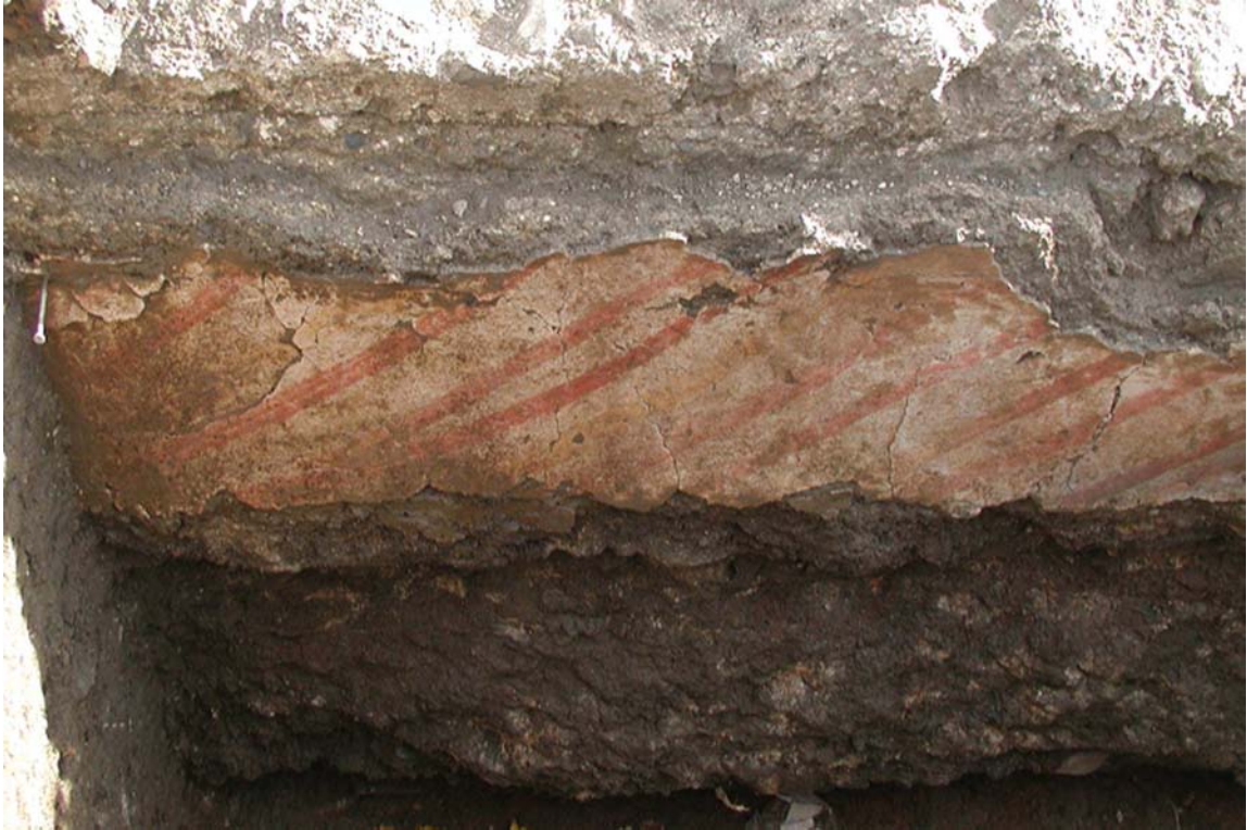
Lámina III. Detalle de la estructura de opus caementicium con restos de revestimiento de estuco policromado a bandas diagonales (U.E. 18).
